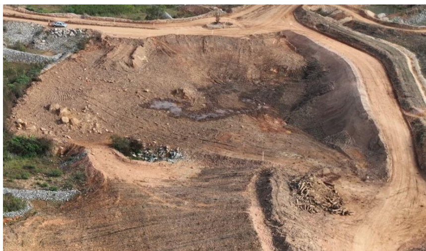
Figura 1 – Em andamento descaracterização das estruturas ASS4
