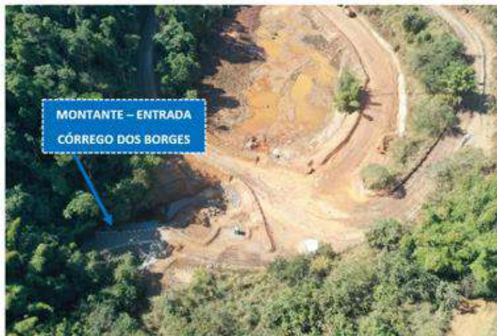
Figura 20 - Montante Córrego dos Borges
