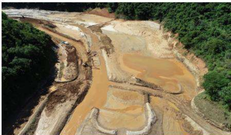
Figura 3 - Canal de Drenagem – Setor 4
