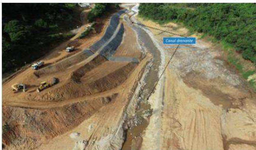
Figura 11 - Vista aérea do reservatório Setor 4
