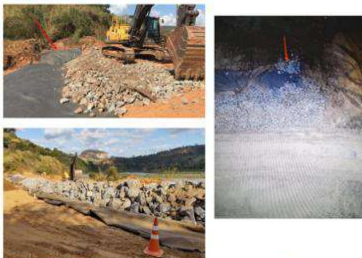
Figura 19 - Dreno do tubo de direcionamento de efluente do setor 1
